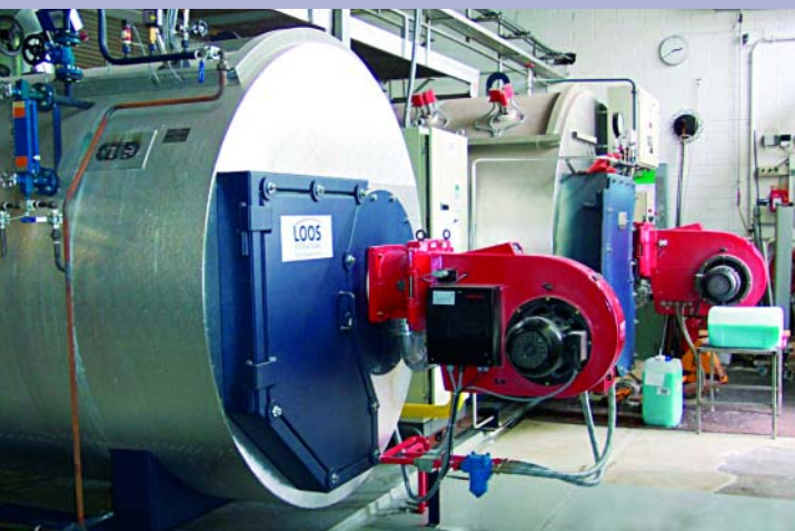
Die neuen Dampfheizkessel der Rehm KG
