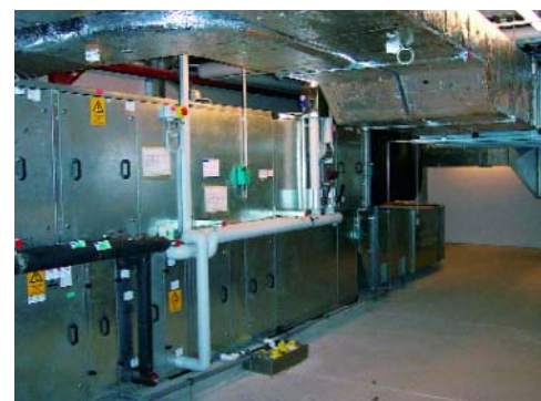
Die neue Lüftungstechnik
