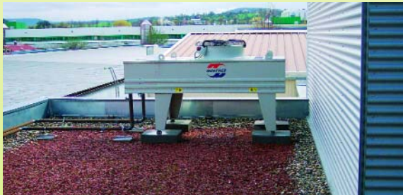
Das Rückkühlwerk auf dem Dach der Versandhalle: Freikühlung im Winter, Abfahren der Überschusswärme im Sommer
