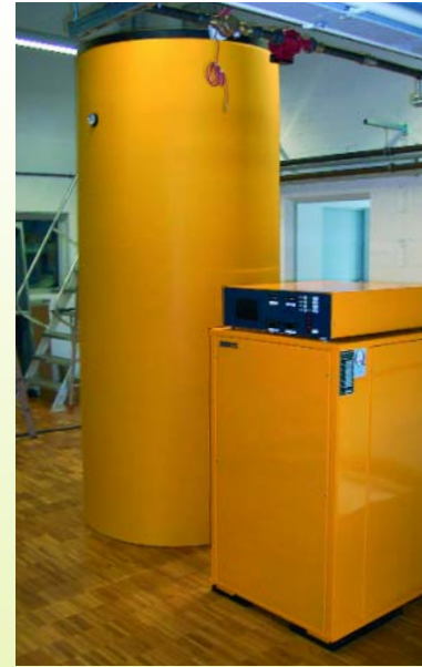
Wärmepumpe zur Kühlung des Prozesswassers und zur Erzeugung von Warmwasser – links daneben: der Pufferspeicher
