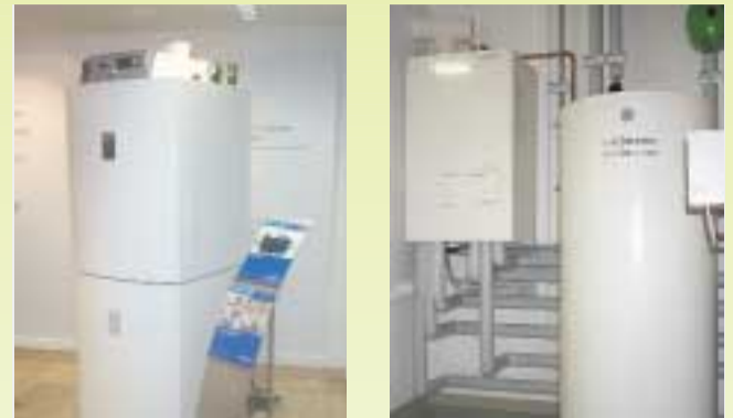
Ob moderner Öl-Heizkessel oder fortschrittliche Gas-Brennwertanlage: Ein saniertes Heizsystem spart viel Energie
