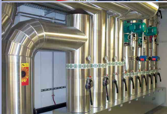
Blick in eine der sanierten Heizzentralen von Stihl
