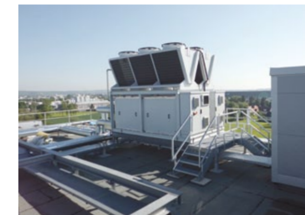
Die neue Kältemaschine
