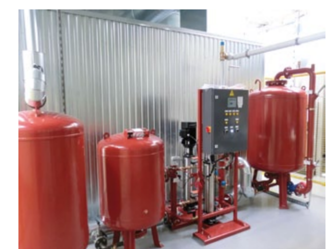
Druckhaltestation Foto: Dürr Systems GmbH
