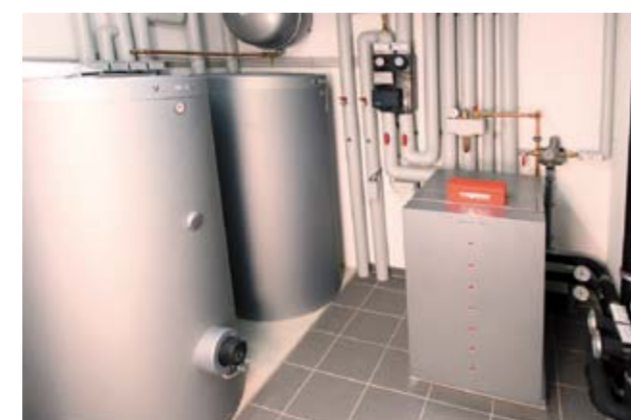
Auch die Technikzentrale ist ein echtes Schmuckstück
