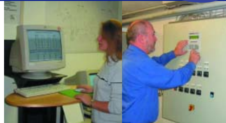
Fernüberwachung: Leitstelle bei Schetter (links) und Fernüberwachungsmodul beim Kunden (rechts).
