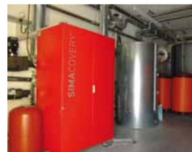
Blick in die Nahwärmezentrale
