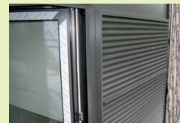
Lüftungsgitter in der Außenfassade.
