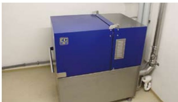
Produziert Wärme und Strom: BHKW von EC Power.
