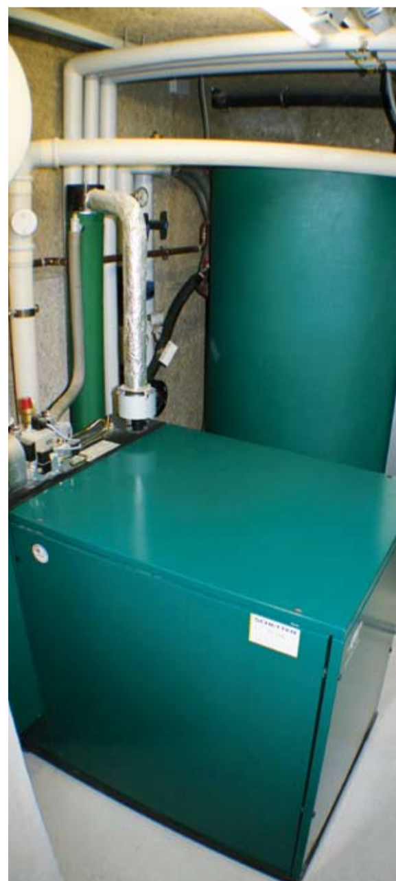
▲ Die gesamte Anlage kompakt auf engstem Raum installiert.
