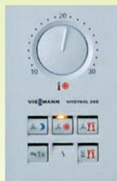
Attraktive Schaltzentrale: Die Steuerung zur Regulierung des Raumklimas befindet sich im Wohnzimmer
