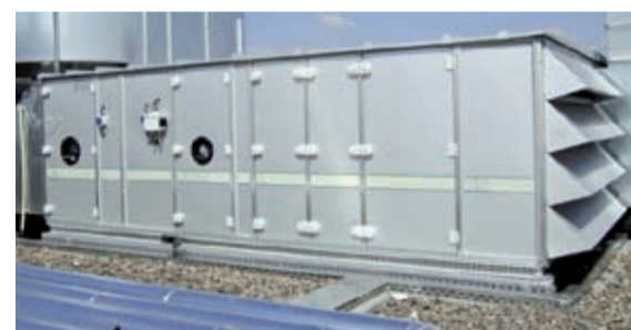
Platzsparend: Die RLT-Anlage befindet sich auf dem Dach
