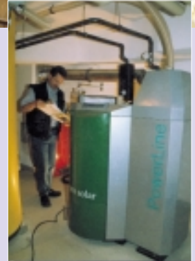
Gut für Gemeindekasse und Umwelt: die neue Holzpellettheizung des Gemeindehauses
