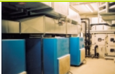
Im Keller des Werks stehen die beiden Druckluftkompressoren mit Wärmerückgewinnung.
