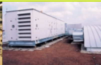
Auf dem Dach ist die Lüftungstechnische Anlage für die Produktion im Obergeschoss installiert. Rotationswärmtauscher, Kältemaschine und Befeuchterkammer sind komplett integriert.
