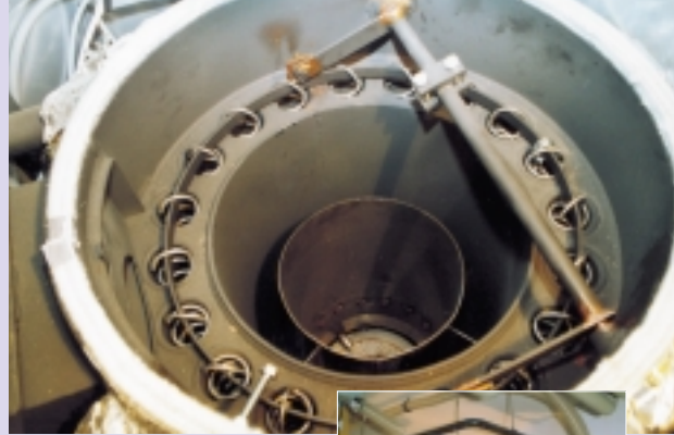
Blick in den neuen Pelletkessel: Seine Leistung sorgt im gesamten Gemeindehaus für angenehme Wärme bei günstigen Energiekosten.
