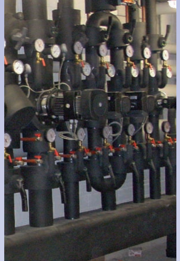
Kälteverteiler im Neubau
