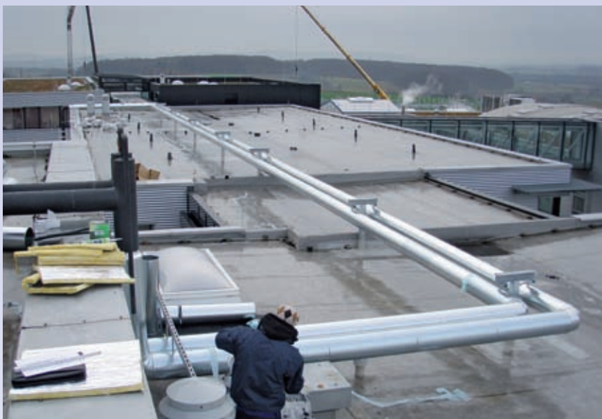
Fernleitung für Kälteversorgung über bestehendes Prüfstandsgebäude
