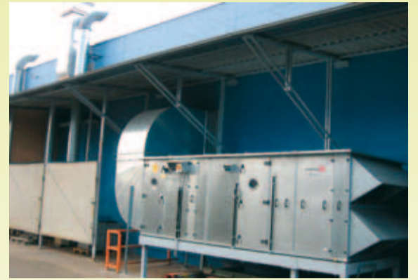
Modernes Zuluftgerät mit effizientem Zuluftventilator
