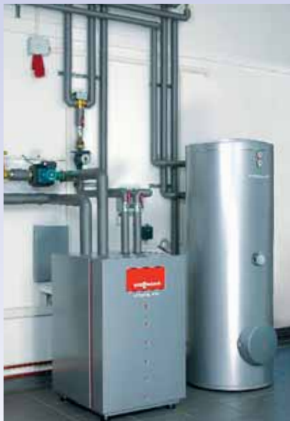
Wärmepumpen sind in puncto Energie-Einsparung eine Technologie der Zukunft
