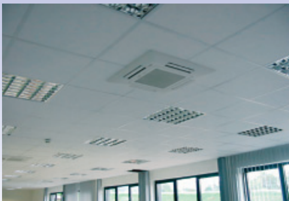
Die Deckenkassettengeräte zur Kühlung der Büros
