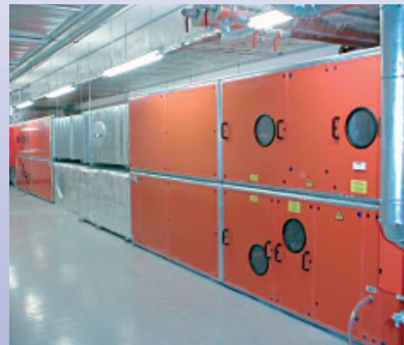
Gute Ideen: Blick in einen Technikraum à la Menerga
