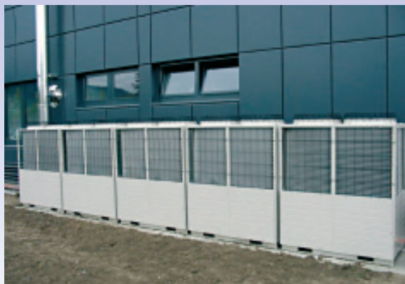
Die Außeneinheiten der Klimaanlage
