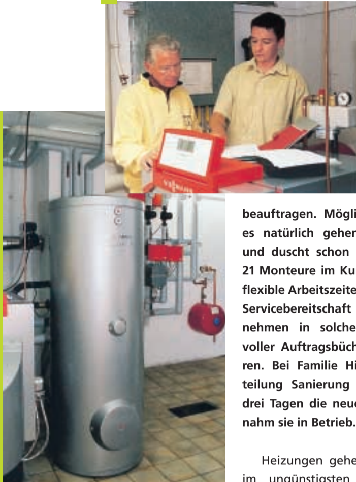
Klein und leise: die neue Ölheizung bei Familie Hille
