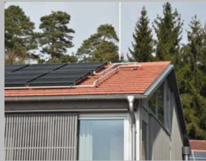
Solar-Luftabsorber auf dem Dach des Gebäudes
