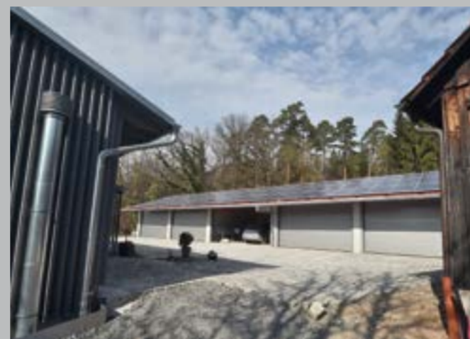
Fotovoltaik-Anlage zur Stromerzeugung
