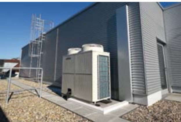
Kältemaschine zur Klimatisierung der Bürobereiche
