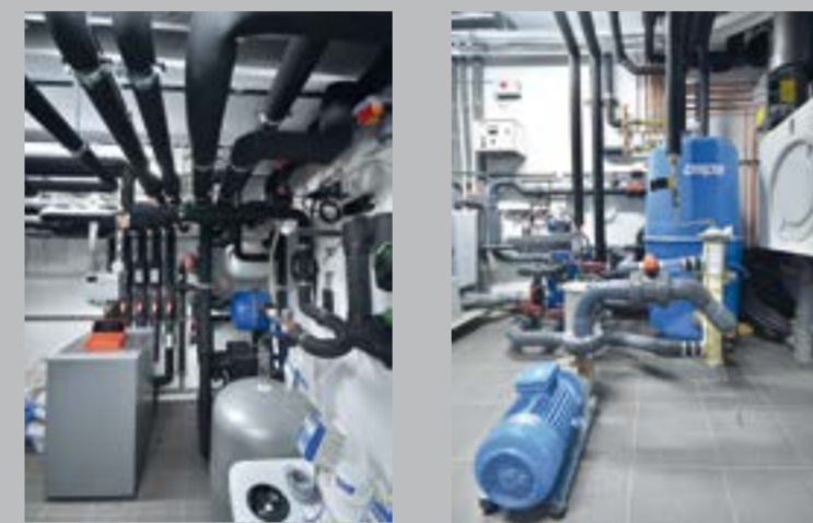
Wärmepumpe und Schwimmbadtechnik
