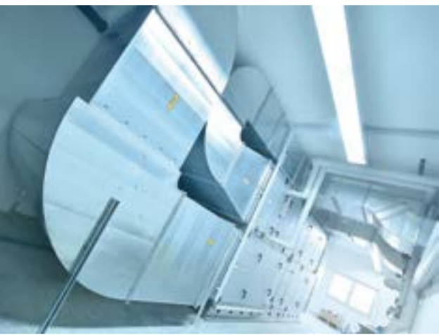
Das neue Lüftungsgerät
