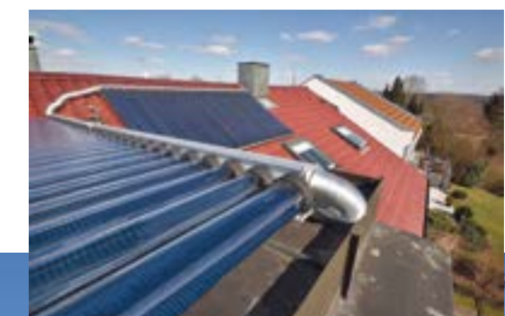
Hochwertige Solarkollektoren auf Gaube und Dach
