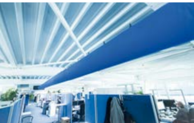
Über ein Textilschlauchsystem wird gekühlt und geheizt
