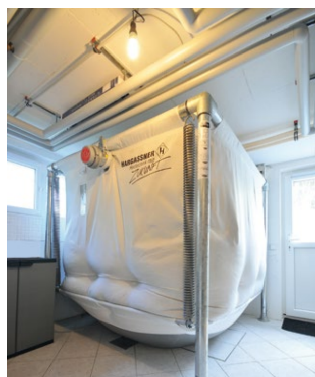
Pelletlager für die Heizung
