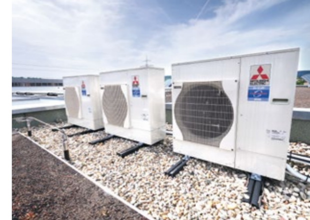
Klimageräte zur Kühlung der Serverräume
