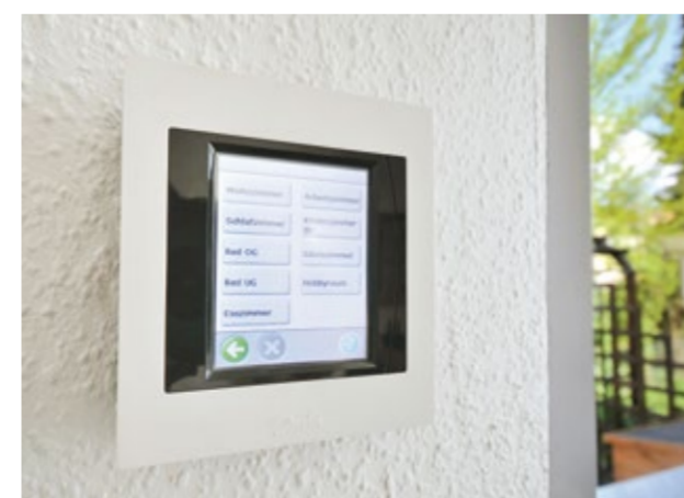
Die Heizung kann bequem per Touchpanel vom Wohnzimmer gesteuert werden
