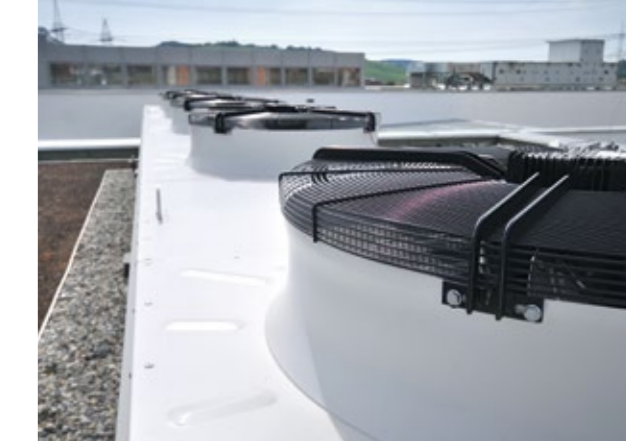
Rückkühlanlage zur Nutzung der Außenluft
