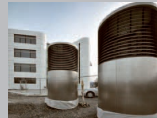
Die beiden Lüftungstürme sorgen für optimalen Luftaustausch
