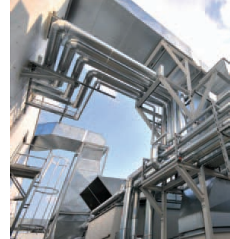
Ein Teil des Rohrleitungsnetzes
