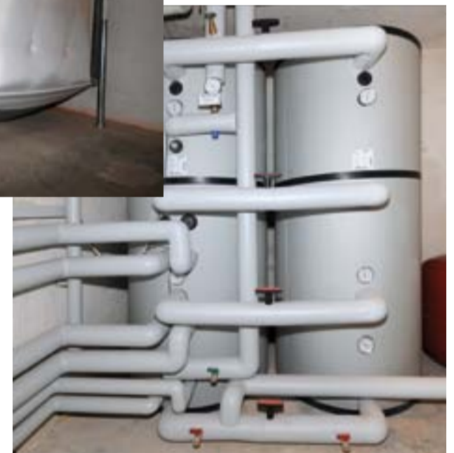
Die beiden Pufferspeicher und das Pelletlager (oben links)
