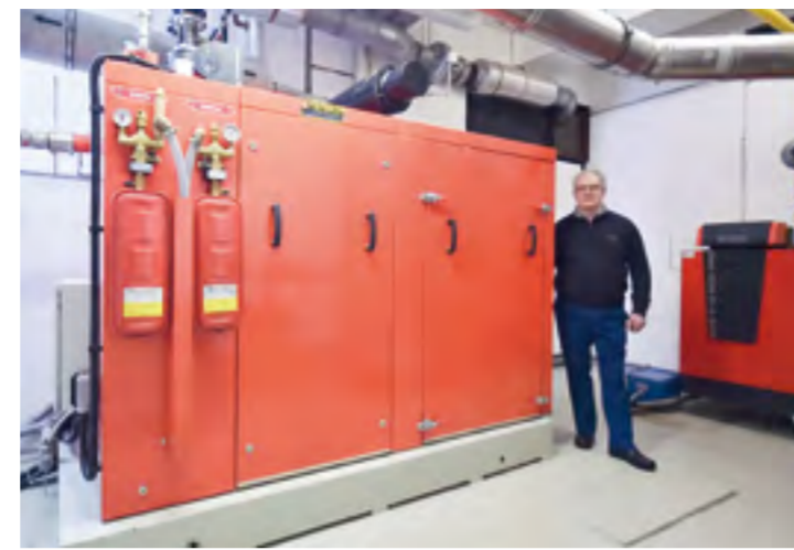
Miteigentümer Francis Bilstein zeigt das neue BHKW
