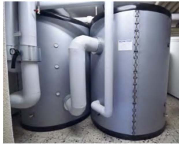
Die Pufferspeicher der Anlage
