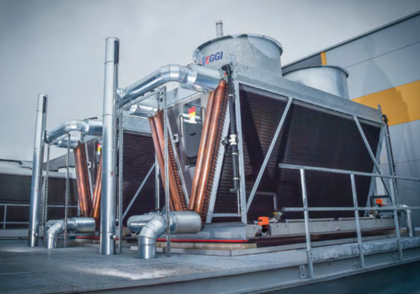
Hybrid-Rückkühler auf dem Dach des Gebäudes
