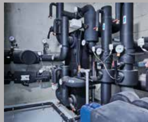
Hydraulische Verschaltung zwischen Eichgraben und Wärmepumpe, getrennt durch einen Wärmetauscher
