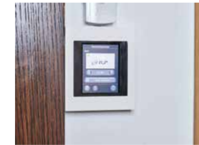
Heizungssteuerung vom Wohnzimmer oder Smartphone aus
