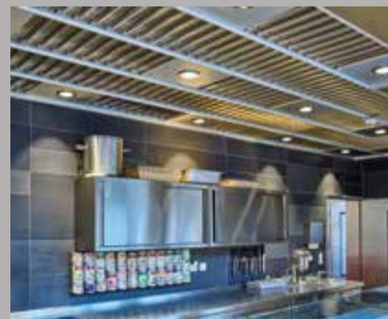
Abluftdecke in der Catering-Küche
