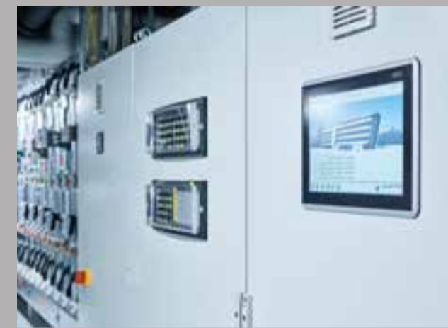
MSR-Technik zur Steuerung
