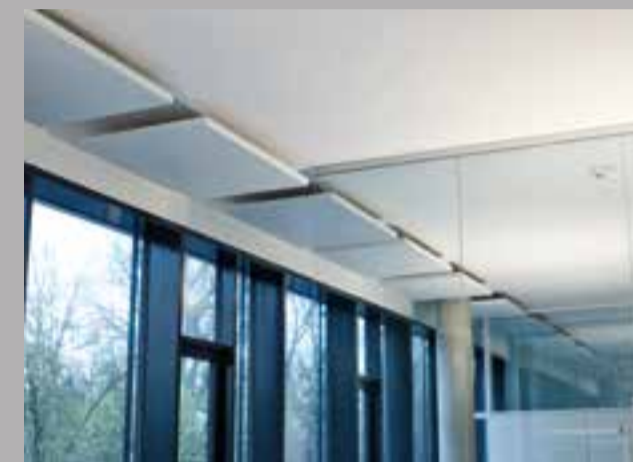
Heiz- bzw. Kühlsegel zur Temperierung der Räume
