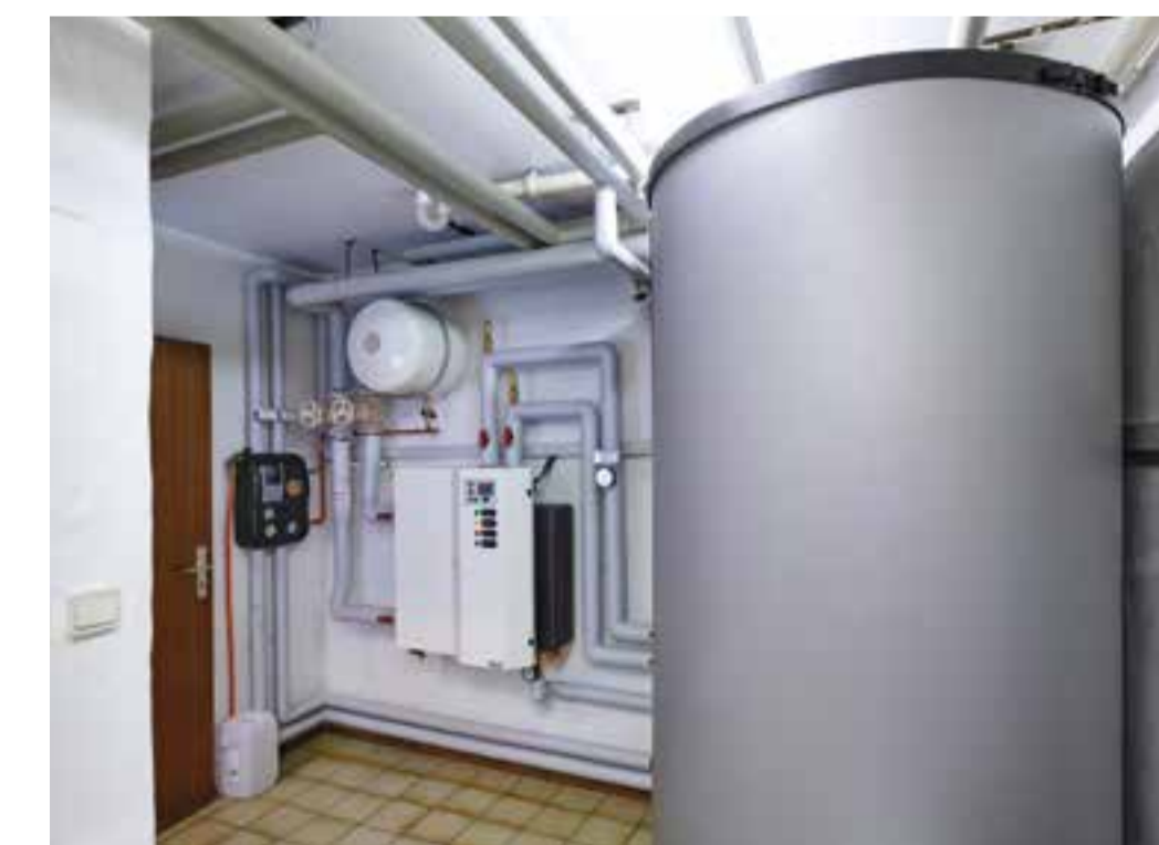
Fernwärmestation sowie Wärmespeicher mit Brauchwassertauscher
