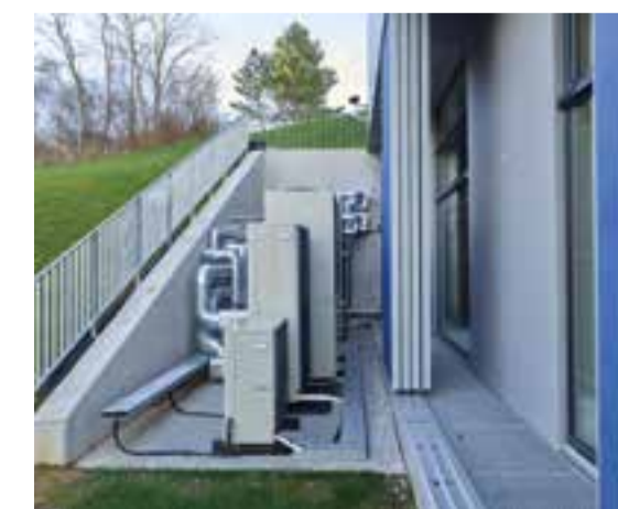
Gasmotor-Wärmepumpe, die heizt und kühlt
