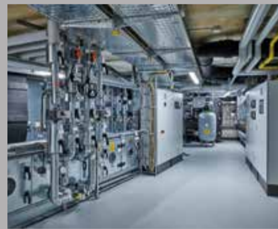
Einblick in die Haupt-Technikzentrale
