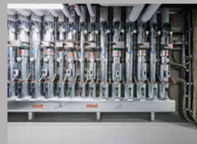
Heiz- und Kältekreisverteilung
