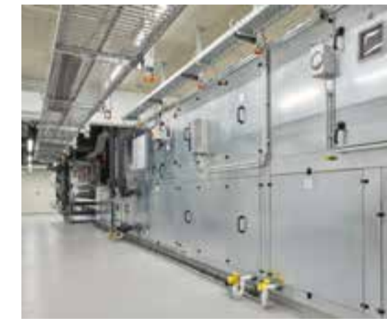
Das neue Lüftungsgerät mit Wärmerückgewinnung
