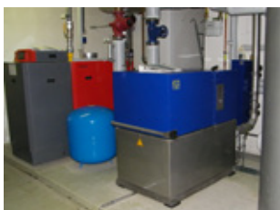
Einzigartig und innovativ – als einer der Ersten in der Branche installieren wir ein Blockheizkraftwerk.
