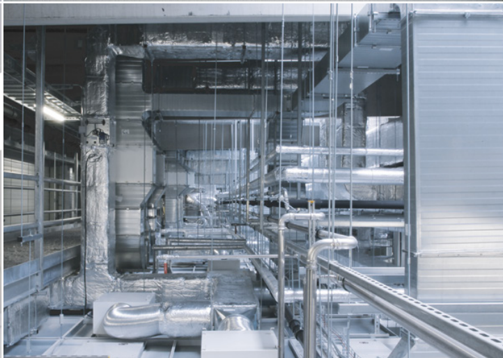
Luftführung auf der Reinraumdecke
