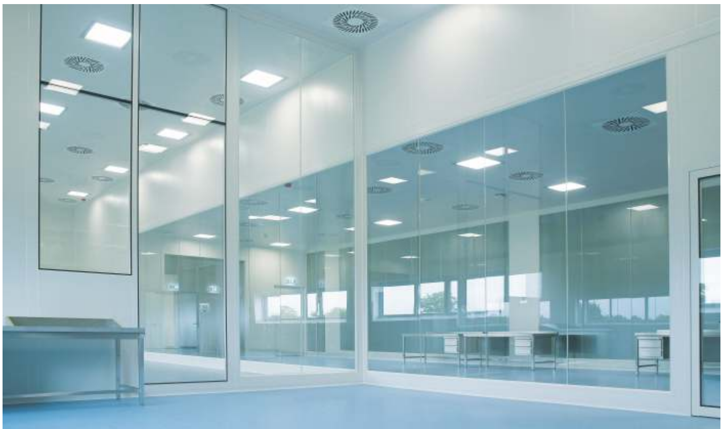
Reinraumwand mit Glaselementen
