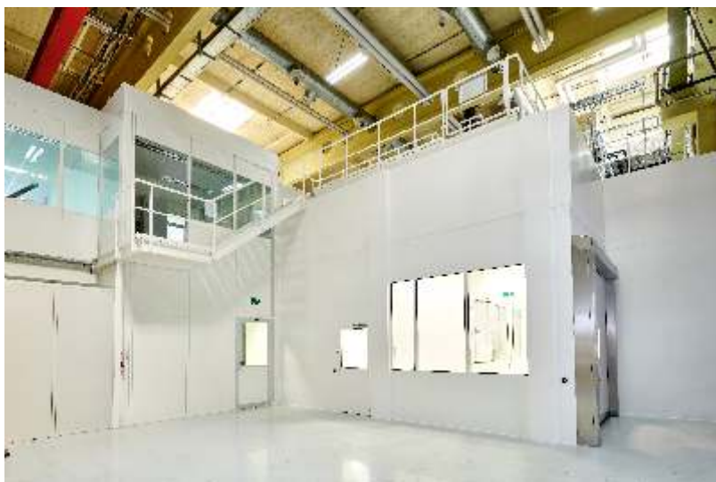
Eingangsbereich in den Reinraum mit Personenschleuse
