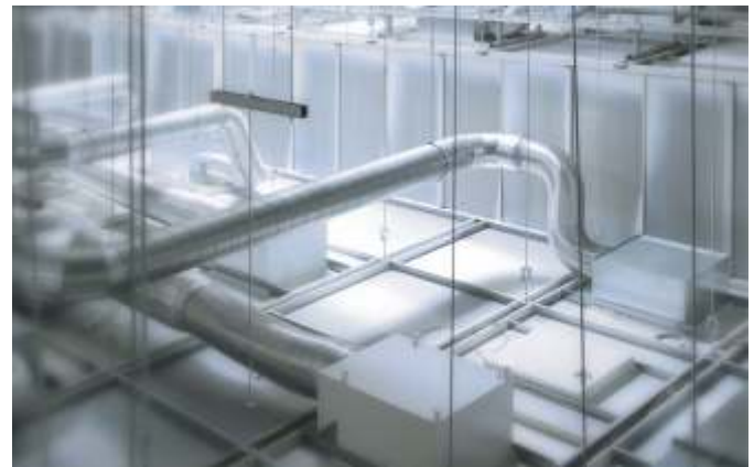
Luftführung auf der Reinraumdecke
